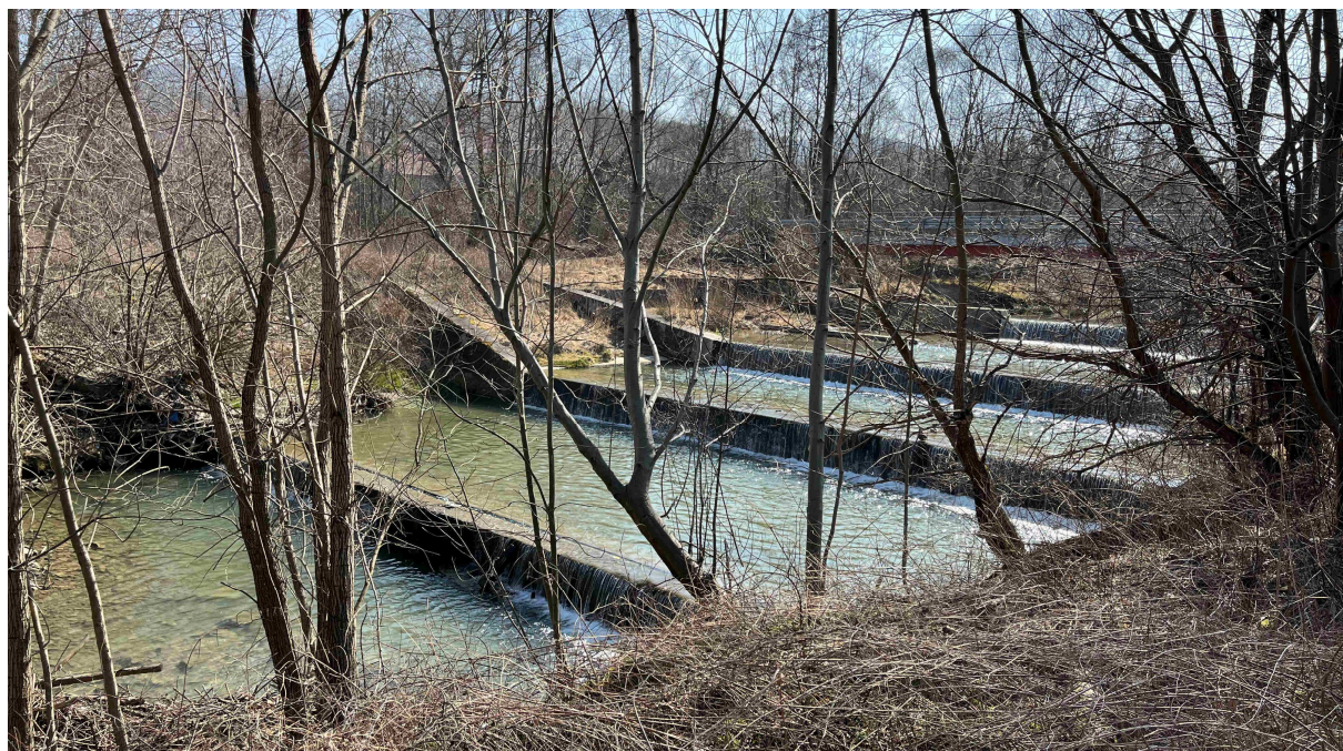
Cztery stopnie, niecki wypadowe i gurty kaskady przeciwoerozyjnej poniżej mostu na Lubieńce w okolicy kościoła w Lubniu (km 1+025) (fot. Paweł Mikuś, 2022-03-24)
